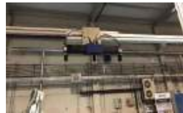
Figura 8. Cámaras de estereovisión para identificación de refuerzos y soportes.
