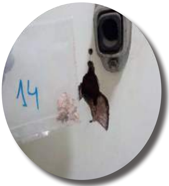
Figura 6: detalle de un panel de acomodación con fibras de asbesto (crisotilo)
