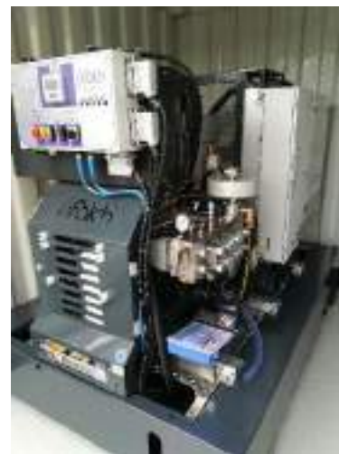
Unidades BASEJET 125 kW de INDASA montadas en contenedor
