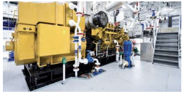
Sala de máquinas del buque (fuente: Revista Buques y Equipos de la Marina Civil)
