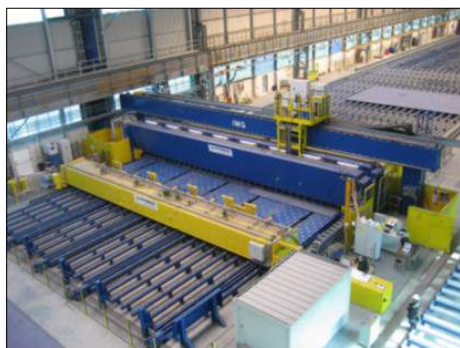
Figura 4. Instalación desarrollada por IMG para la soldadura láser-híbrido de paños en el astillero FINCANTIERI en Italia.
